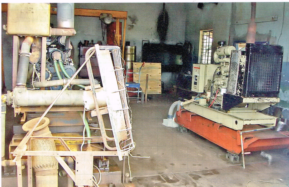
Storende generatoren in de ELWA compound
